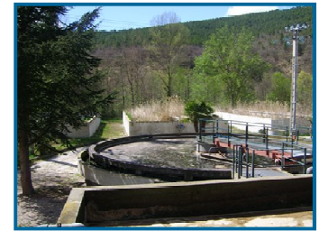
Clarificateur station d'épuration
