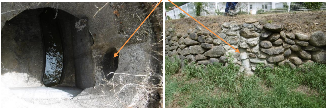
Déversoir par trop plein
